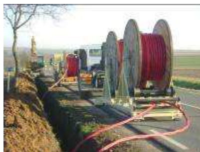
Réseaux d'éoliennes à Fruges
