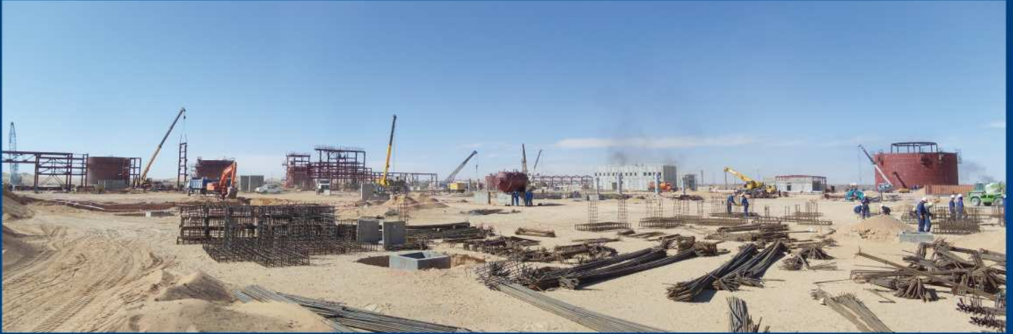
Centre de Traitement d'Hydrocarbures - RHOURE-NOUSS
